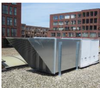
Geluiddemper dakbron in woonwijk
