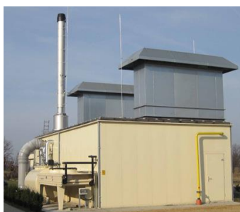
Geluidsisolerende omkasting WKK
