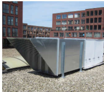
Geluiddemper dakbron in woonwijk
