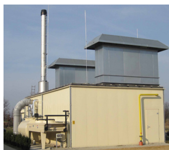
Geluidsisolerende omkasting WKK
